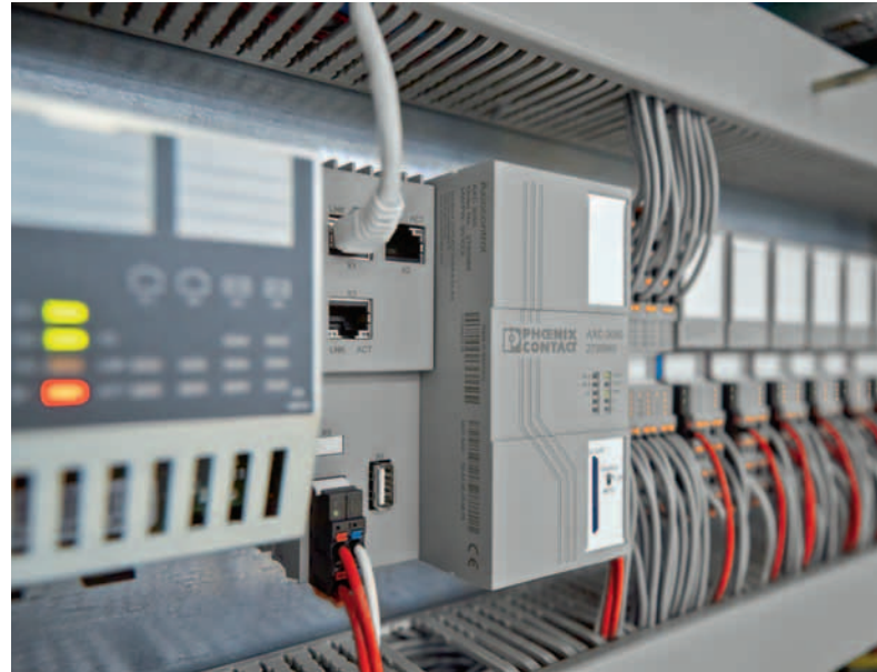
Die Axiocontrol-Steuerung lässt sich selbst in beengten Schaltschränken einfach montieren.
